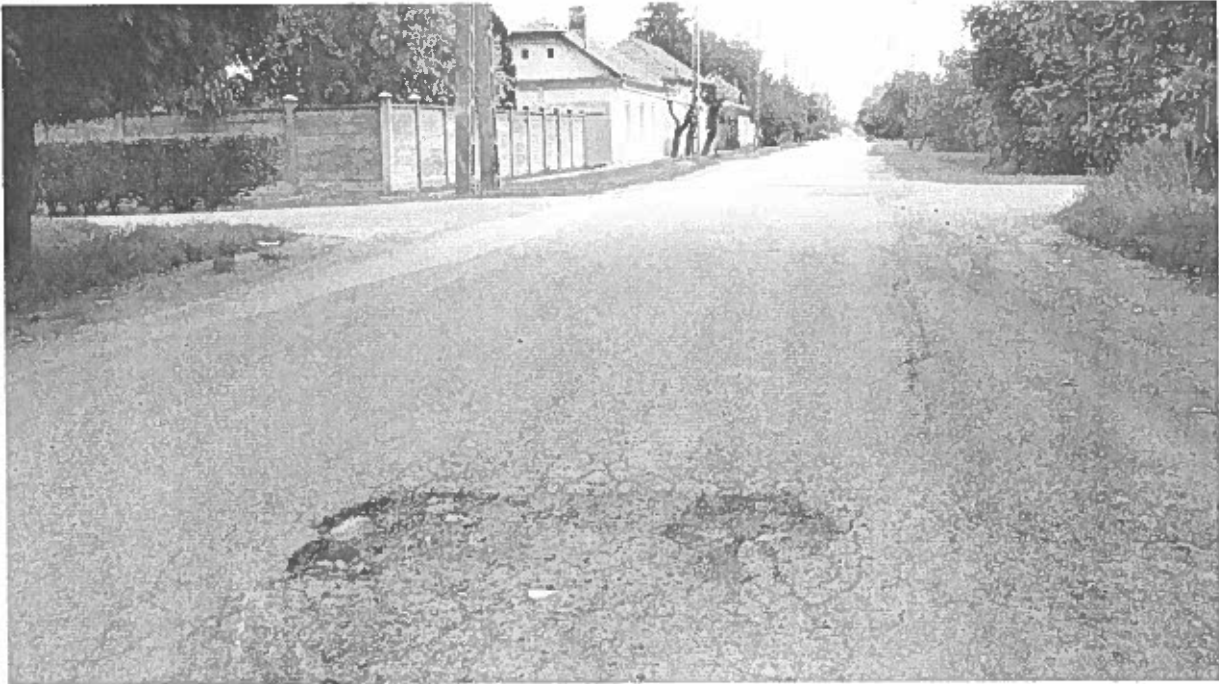
Damjanich utca 658. helyrajzi számú szakaszának burkolati hiányosságai
