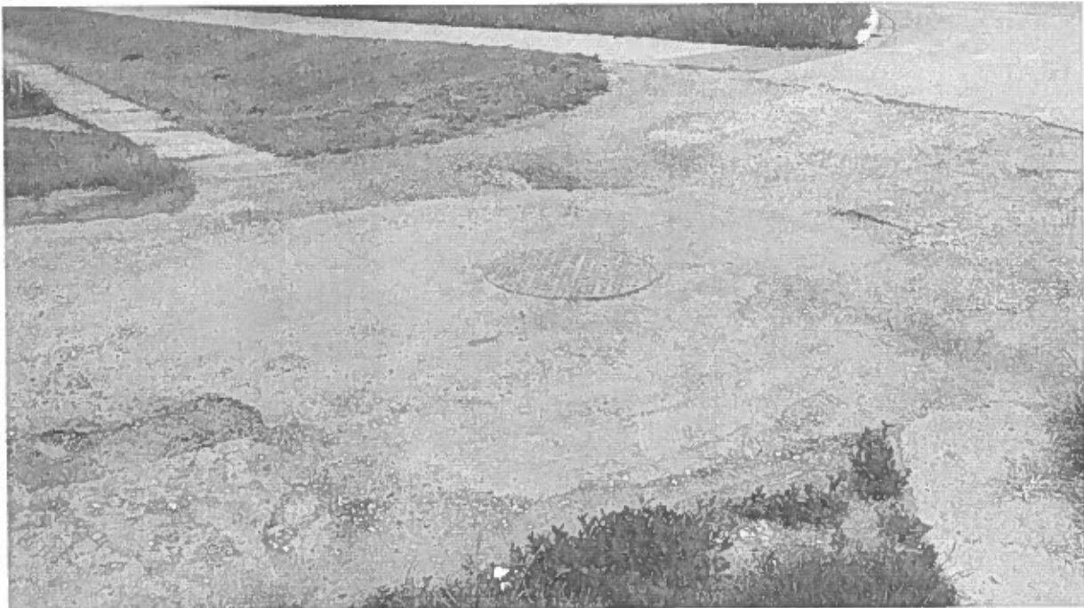
Tulipán utca 1093. helyrajzi számú, Csabai úti rácsatlakozás szakaszának állapota
