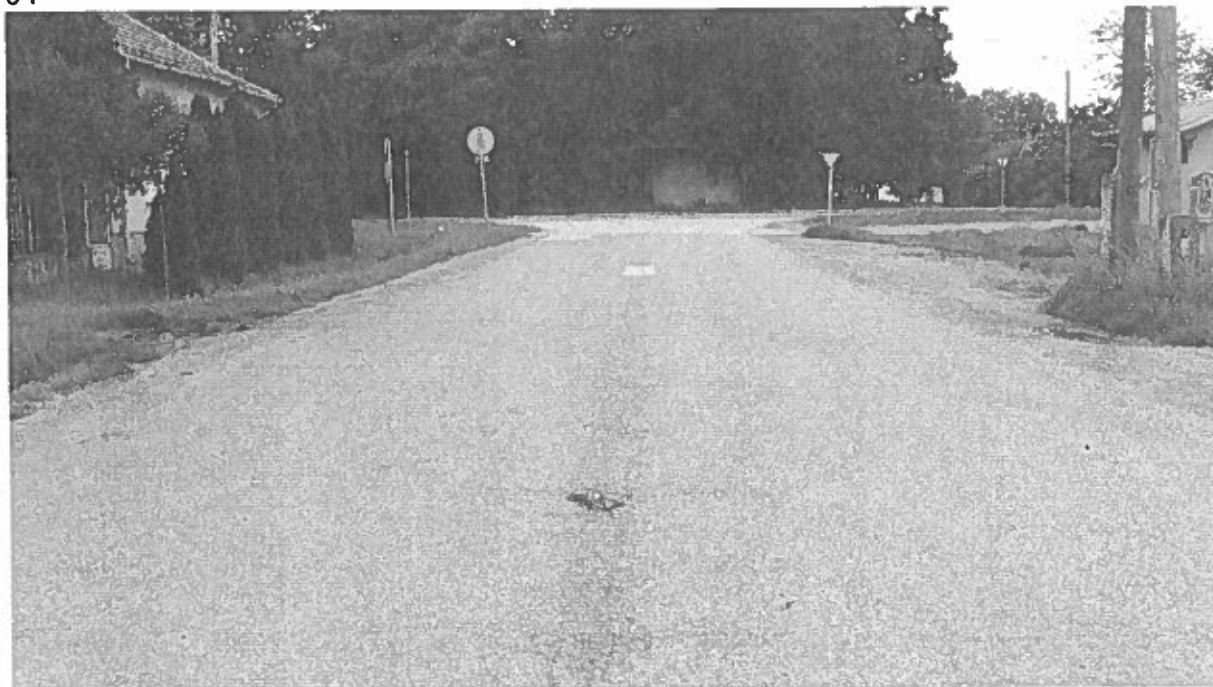
Iskola utca 2179. helyrajzi számú, Csabai úti rácsatlakozás szakaszának burkolat hiányosságai
